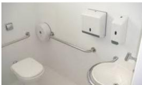
FIGURA 2 - BANHEIRO ADAPTADO A PESSOAS COM DEFICIÊNCIA
